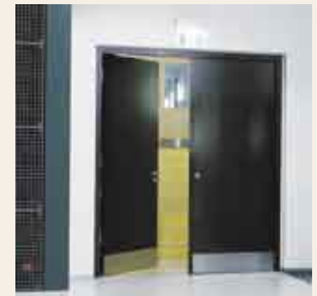
Dwuskrzydłowe przeciwpożarowe drzwi T30 (EI30) i drzwi dymoszczelne oddzielające salę okienek bankowych od pomieszczeń biurowych.
